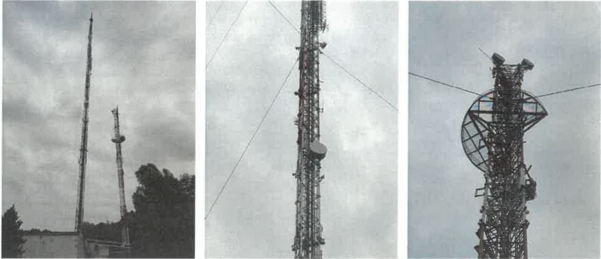
Widok obiektu wraz z zainstalowanym zespołem antenowym
