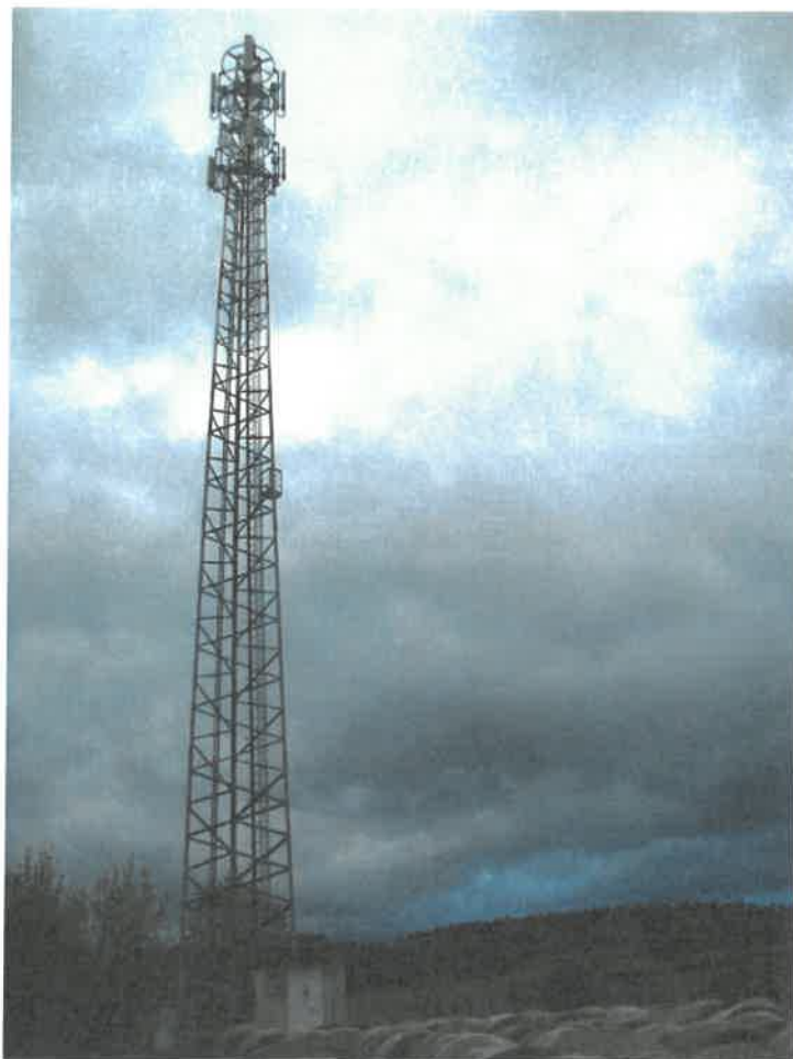
Zał. nr 1: Widok ogólny instalacji radiokomunikacyjnej.
